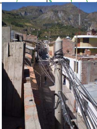
Denso cableado aéreo en calle Arequipa
